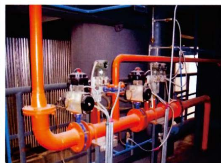
JCQ 运用于煤气总站
